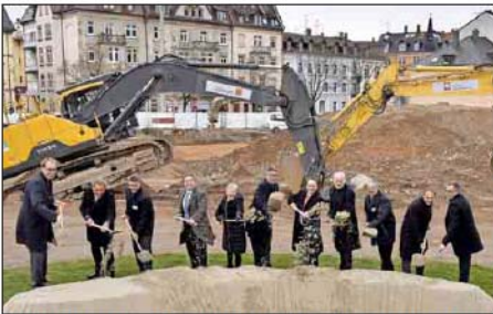
Spatenstich für das neue Stadtquartier auf dem 7.400-Quadratmeter-Areal an der Habsburger Straße FOTO: BAMBERGER/GISINGER
